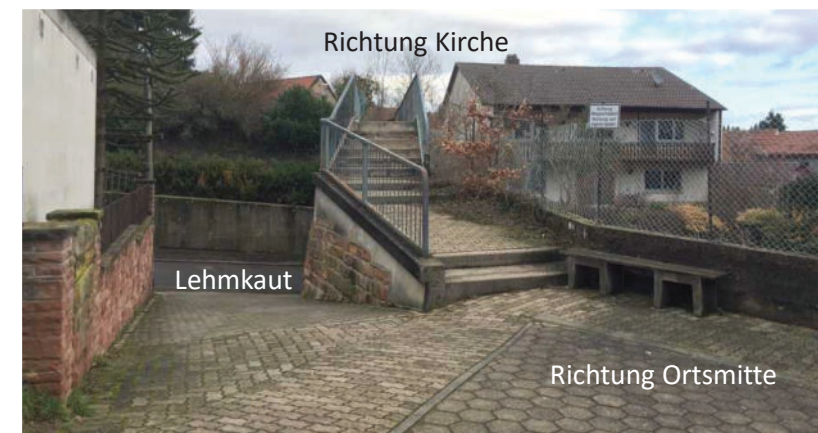
Fußgängerbrücke „An der Lehmkaut“ mit Sanierungs- und Verkehrssicherungsbedarf
