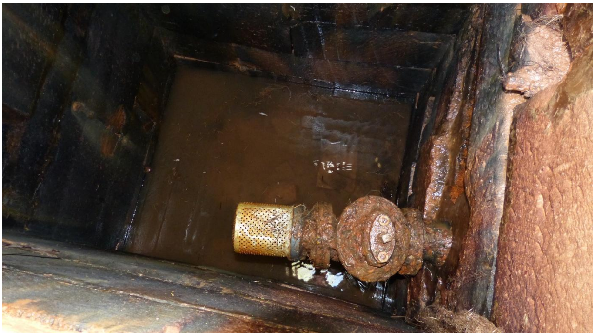
Blick in die Brunnenkammer in der Schwenk im Hinterborn mit Einlaufarmatur und vorgebautem Schmutzsieb
